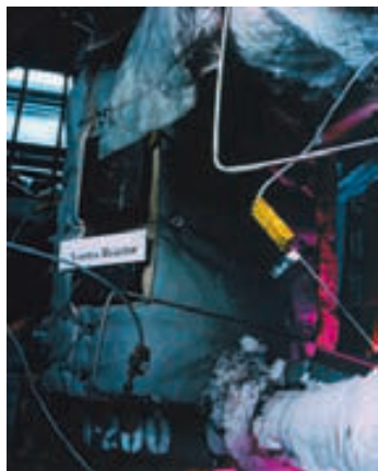
▲ Un reactor para la pirólisis de biomasa.
